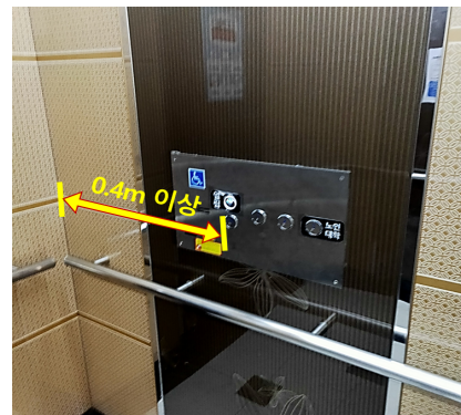
[그림 2] 장애인전용 승강기 내부 조작반 적정설치 사례(센터K)
