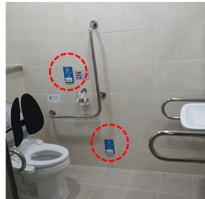
[그림 4] 장애인전용 화장실 비상호출벨 적정위치 설치 사례(센터D)
